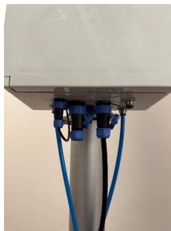
Anschluss an den Lufteinlass für Mast
