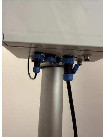
Anschluss an den Sensor
